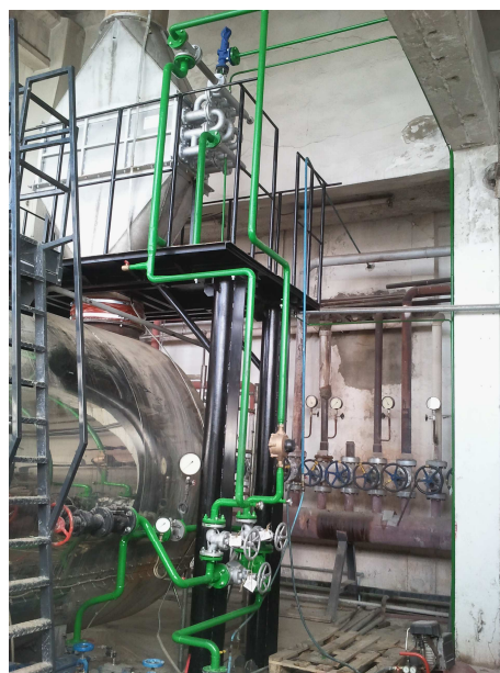
Instalatie de recuperare - Final
